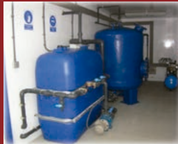
Equips de filtració 50m 3 /h
