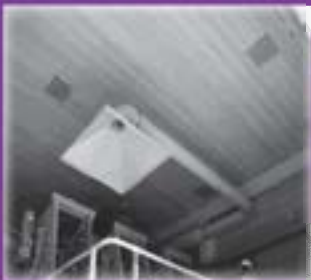
Campana Aspiració de gasos
