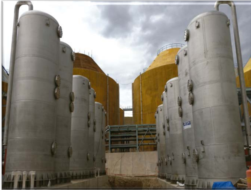
Filtros de Carbón Activo PTAR Atotonilco
