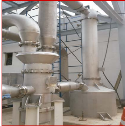
Intercambiador de calor
