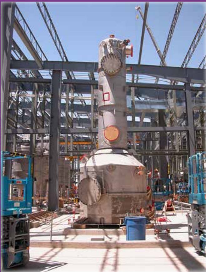
Planta de lavado de Gases (Scrubber)
